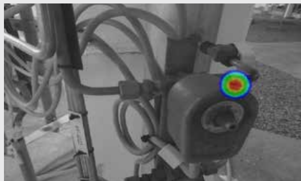
Odstranění úniků stlačeného vzduchu zjištěných pomocí kamery FLIR Si124 může výrobcům ušetřit desítky tisíc dolarů ročně na nákladech za elektřinu.
